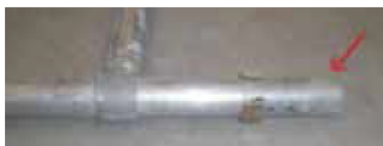
Külgmisel piirderaamil puudub all ümbrisevõru
